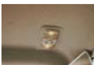
Éclairage intérieur interconnecté avec la porte de la cabine
