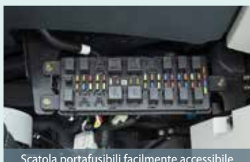
Scatola portafusibili facilmente accessibile
