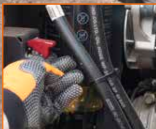
Pompe d'amorçage électrique
