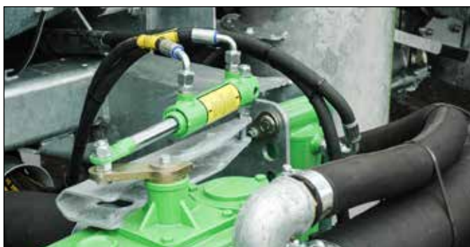
Inversor de bomba hidráulica
