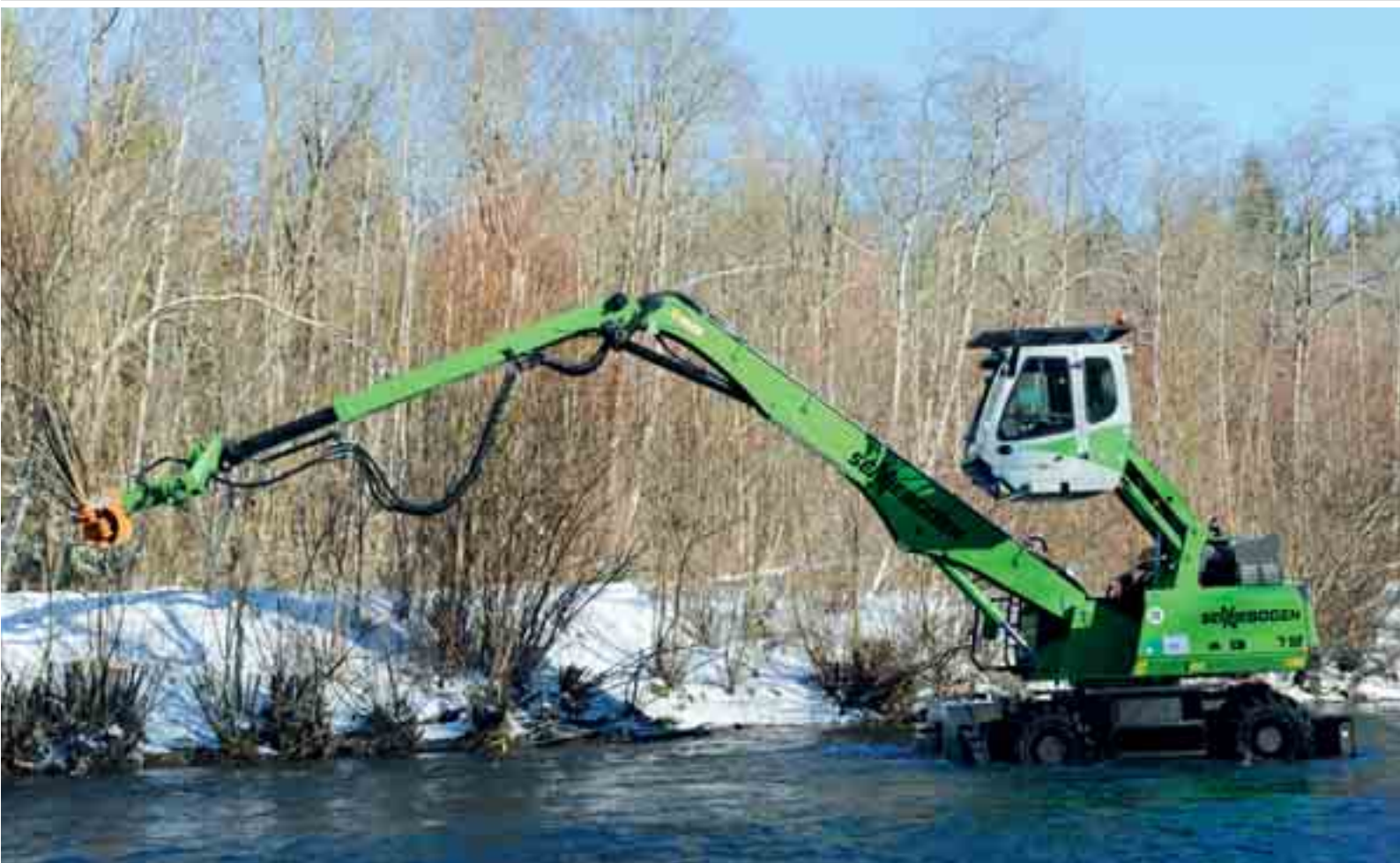
718 - limpieza de orillas y cursos fluviales para la protección o el acondicionamiento de diques; Austria 718 – зачистка берегов и русел рек в целях обеспечения безопасности или ремонта плотин и дамб; Австрия
